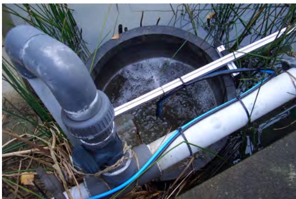
Eingebauter Hyperspektralsensor (die Luftblasen an der Probennahmestelle stammen von der Reinigung der Optik mit Druckluft)
